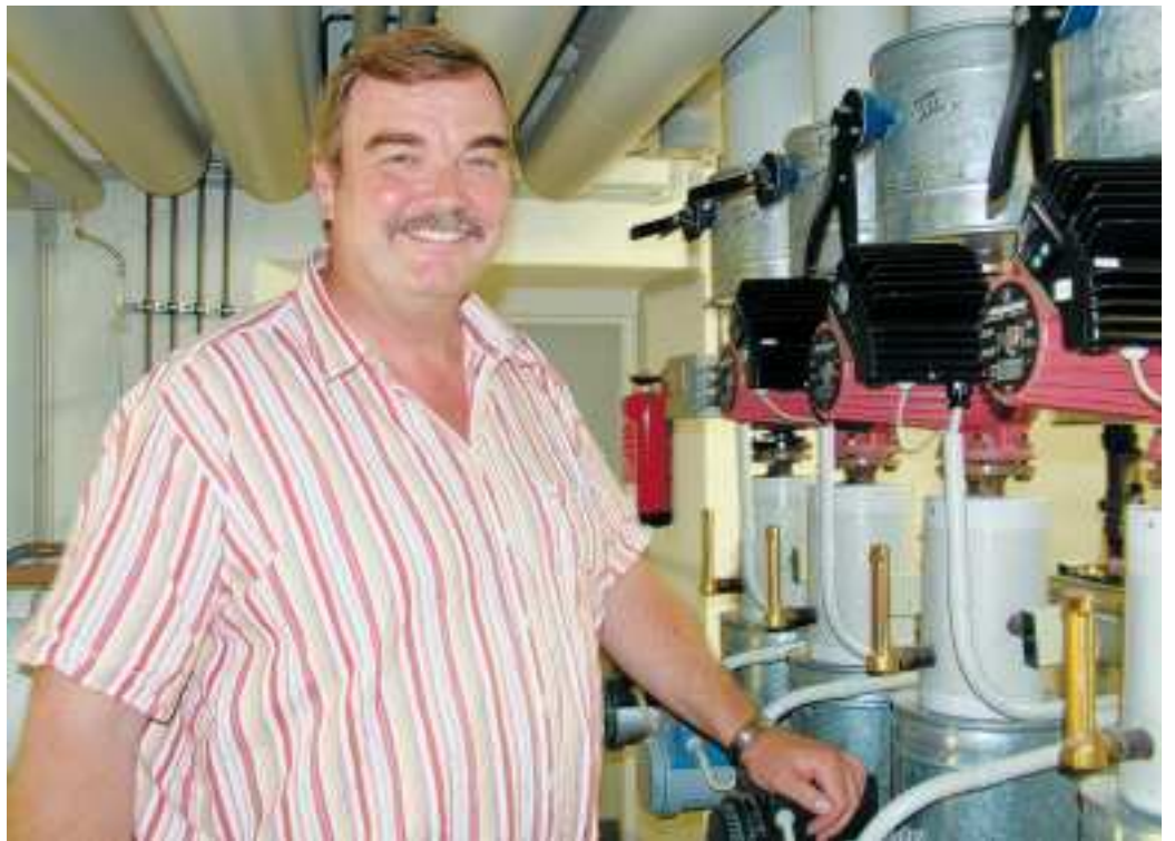
Im Heizungskeller: Hans Rosenhainer sorgt als Hausmeister des Ratsgymnasiums auch dafür, dass Schüler und Lehrer im Winter nicht frieren müssen.
